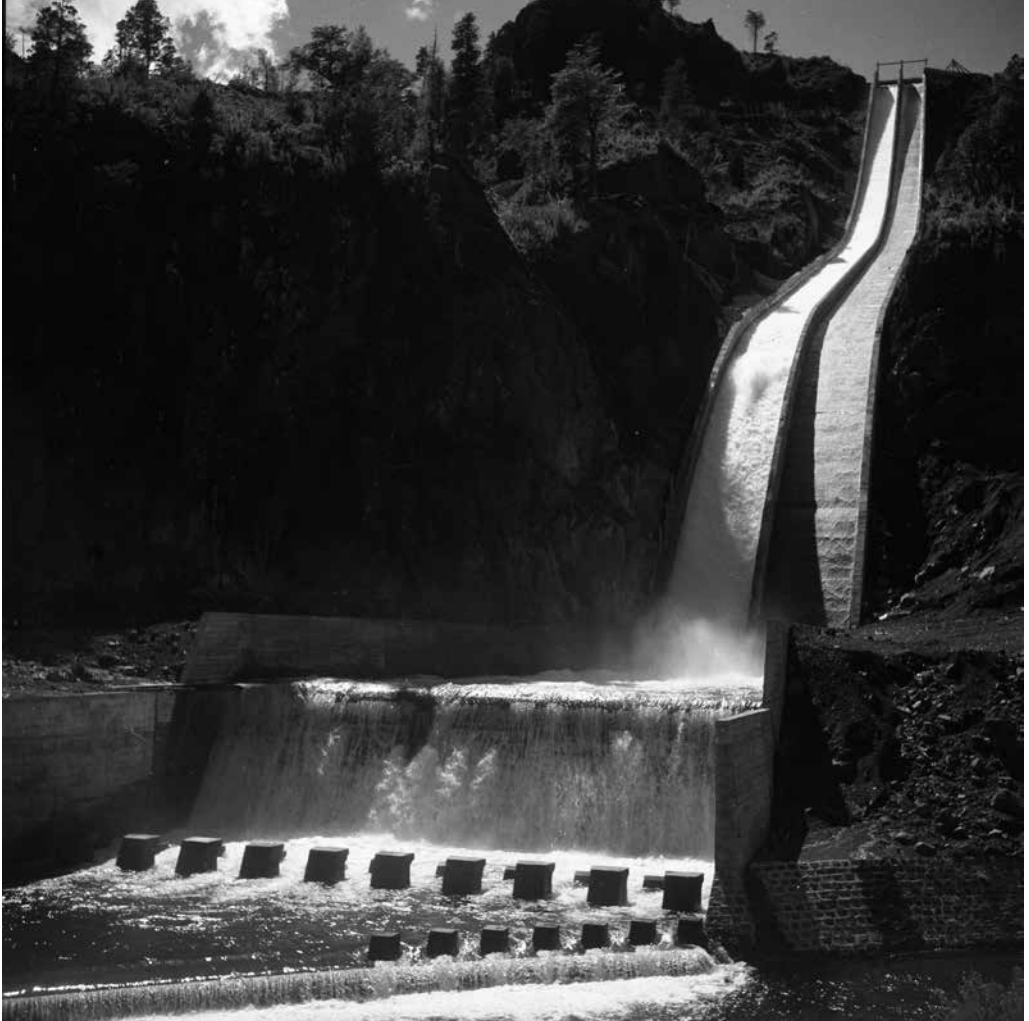
Energía Eléctrica Planta El Abánico, Región del Bio Bio. Fuente: Archivo Central Andrés Bello
