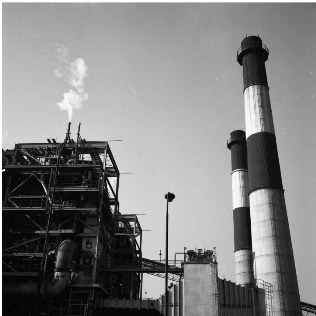
Planta Termoelectrica de Renca. Fuente: Archivo Central Andrés Bello
