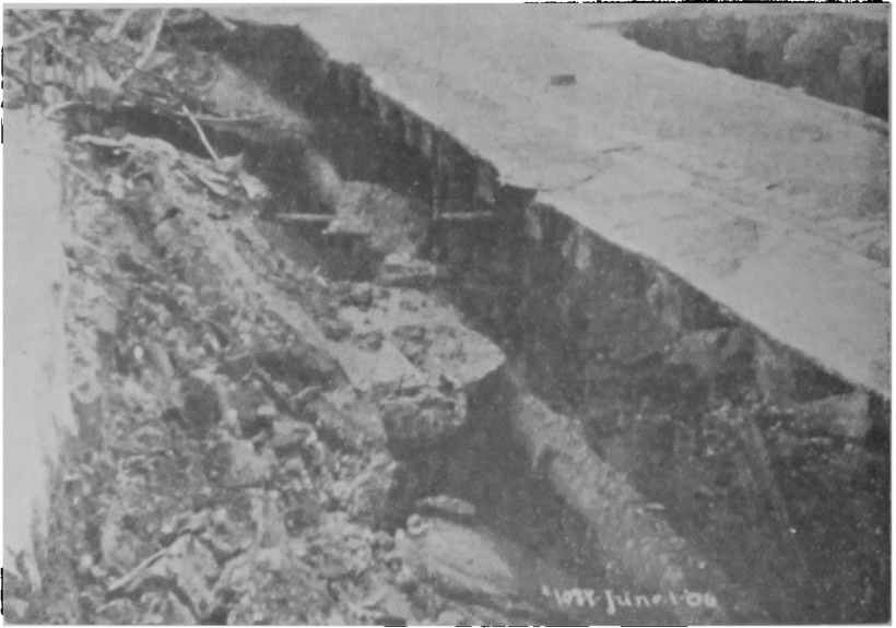
Fig. 23.—Hundimiento de cada lado de la vía de una tranvía (Calle décimo cuarta, al este de la calle de Valencia)
