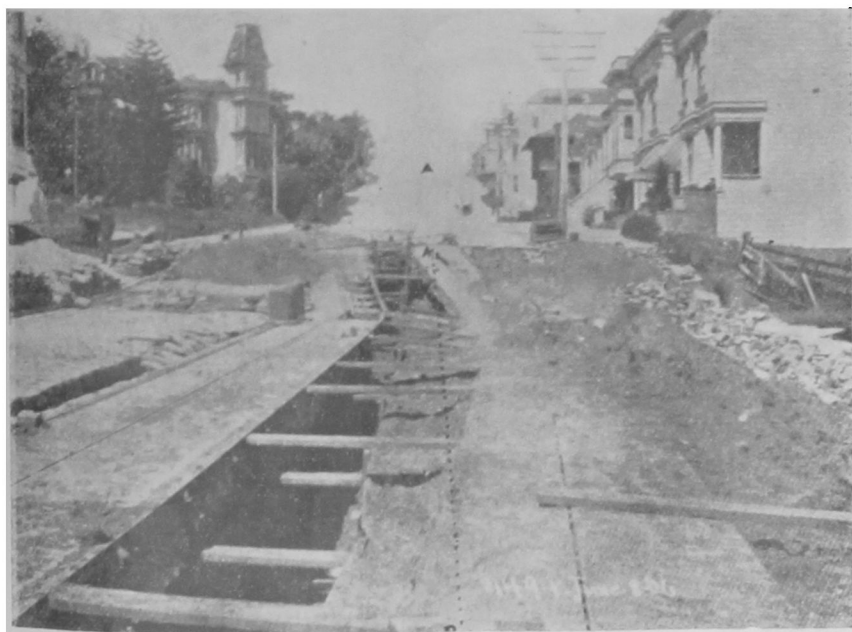
Fig. 26.—Hundimiento con gran movimiento lateral del suelo de la calle i separacion entre la via de la tranvía i el suelo (Calle Union entre las calles Steiner i Pearce)
