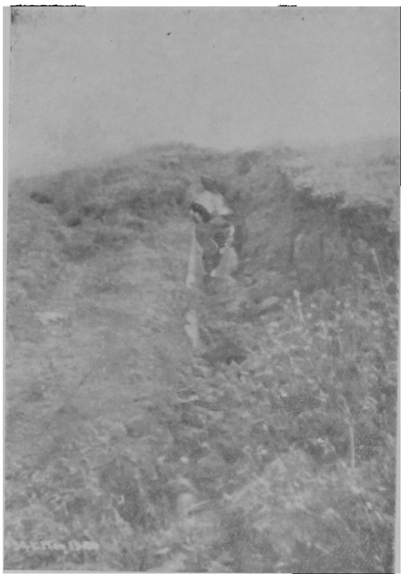
Fig. 18.—Aplastamiento de una cañería en el tránsito de la falla sísmica
