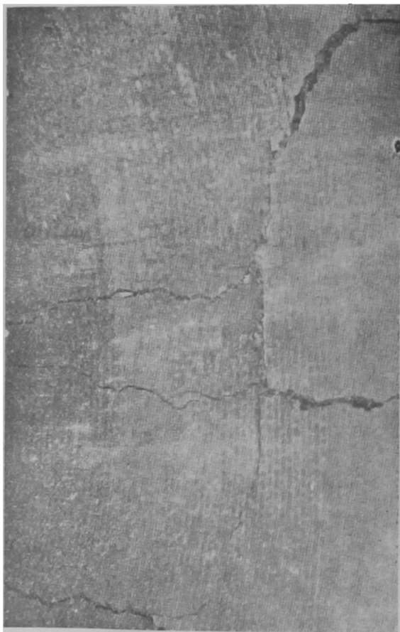
Fig. 13.—Grietas en el pozo de desagüe del estanque de San Andres
