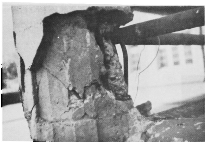
Fig. 22. Daños en un pilar extremo de la marquesina del Hospital.
