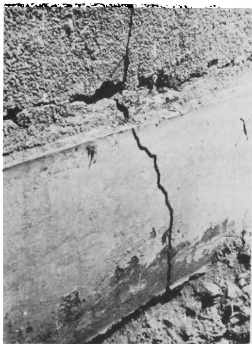
Fig. 14. Población Santiago Amengual. Grieta profunda en sobrecimiento.
