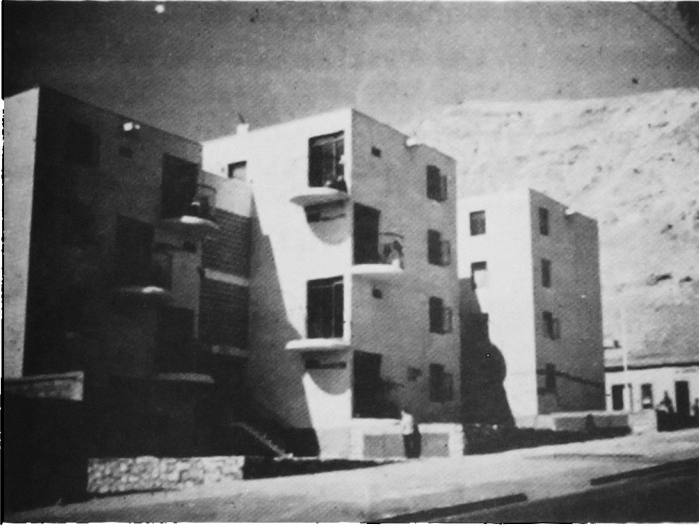
Fig. 24. Edificios de departamentos de Carabineros de Chile. Se observan las grietas en las juntas de construcción.
