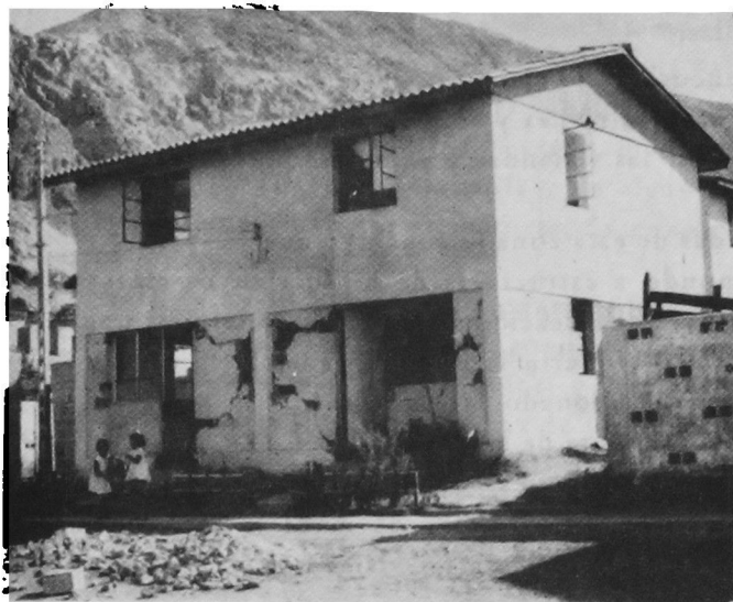
Fig. 13. Población Santiago Amengual. Daños característicos en una de las casas.
