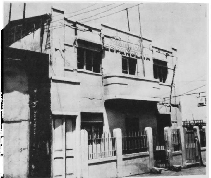
Fig. 35. Vivienda dañada por el sismo.
