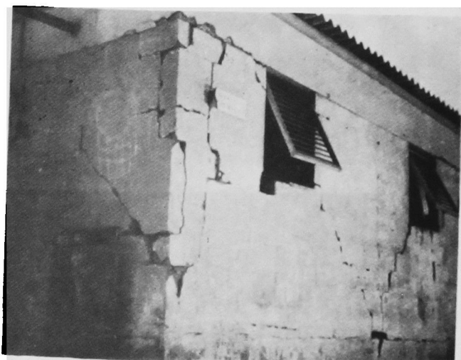
Fig. 16. Grietas en albañilería de bloques, Población Rafael Sotomayor.
